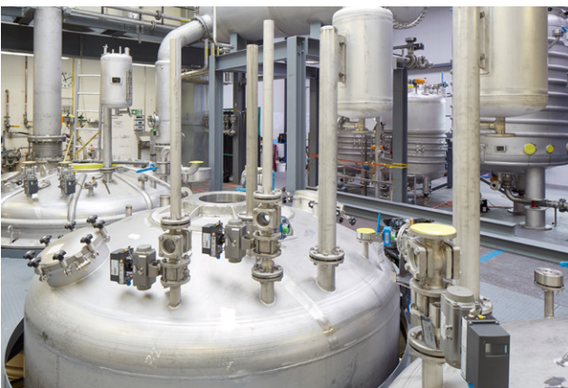
Zwei Reaktoren für die Klebstoff-Polymerisierung im Aufbau, an den Zuleitungen sind die Regelarmaturen (Kugelsektorventile) bereits montiert.
